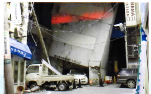
家が傾き、電柱が倒れ、がれきが散乱する街が再現されている
